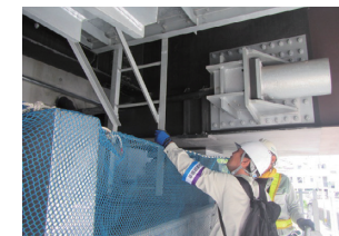
落橋防止システムの被災状況も調査
