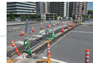
路面に段差が生じた 熊本市内の交通の要衝、白川橋
